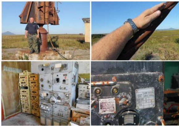
alte Technik, Mast-Isolator, Abspannung
